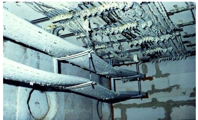
Abb. 4: Kabelanlagen nach einer normgerechten DIN 4102-12 Brandprüfung – keine Trassenenden und Formteile, kein Kantenschutz, keine Schutzkappen, Deckel, Trennstege ...
